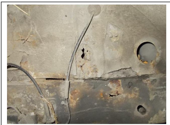
Fot.21. Korozja pola numerowego
